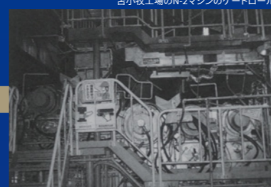
苫小牧工場のN-2マシンのゲートロール
