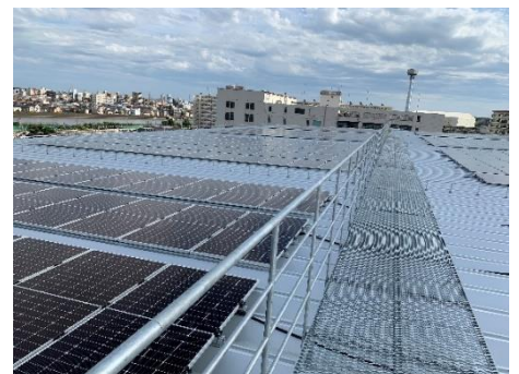
▲太陽光発電パネルを設置した屋上 (江戸川倉庫)
