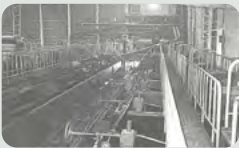
苫小牧工場の新聞古紙脱墨設備
