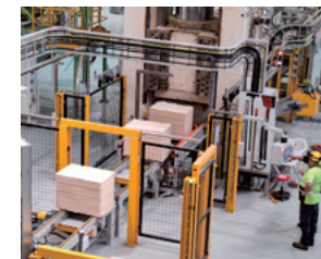
復旧稼働直後の工場パルプ設備
