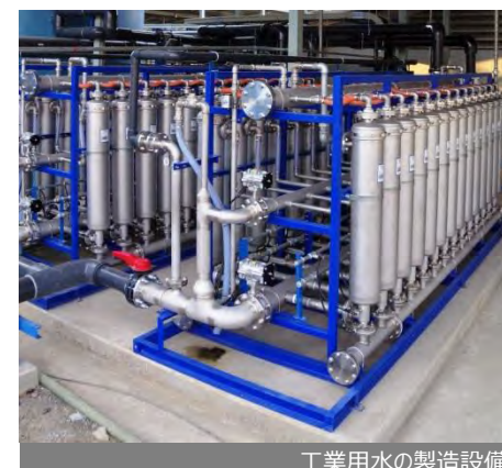
工業用水の製造設備
